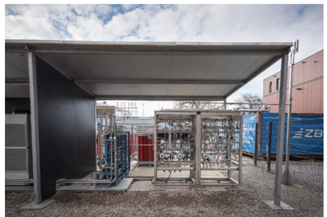
Kompressor mit Ventil- und Instrumentenstation
