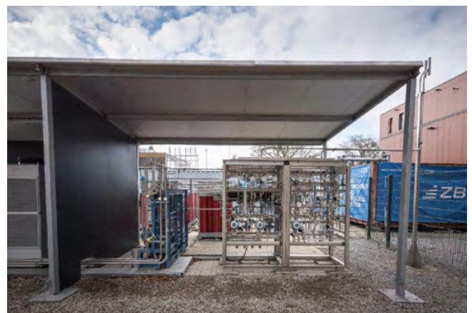
Kompressor mit Ventil- und Instrumentenstation
